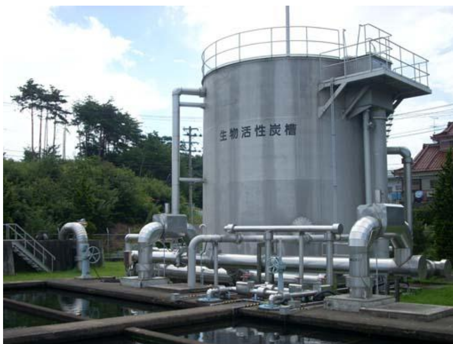
(西川浄水場の生物活性炭槽)
